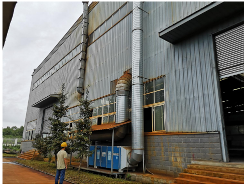
UV 光解+活性炭处理装置及排气筒
