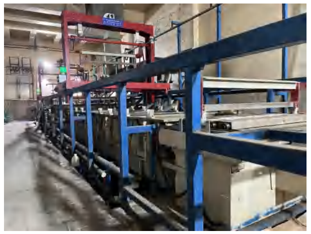
2#厂房-镀锌生产线（地上槽体/生产线）
