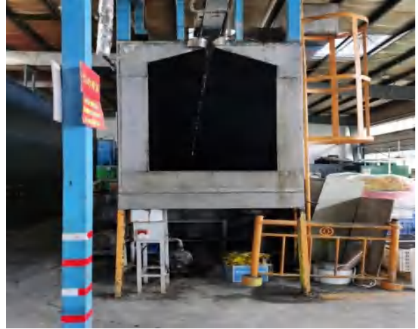
1#厂房-电泳生产线（地上式）
