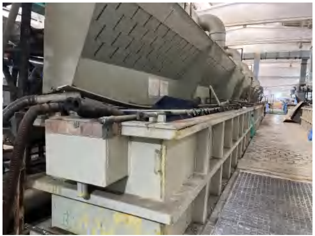
2#厂房-塑料镀铬（地上槽体/生产线）
