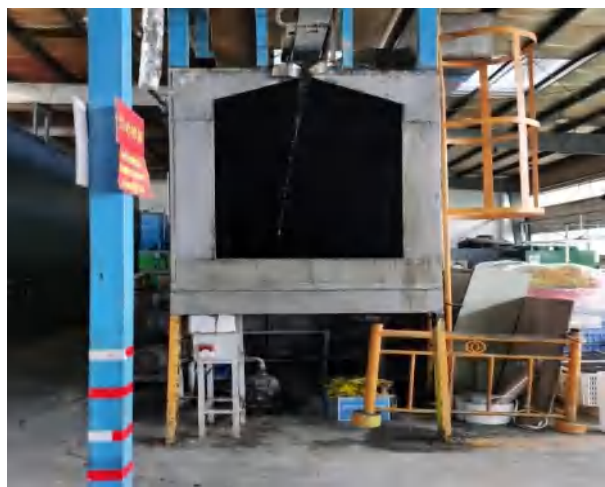
1#厂房-电泳生产线（地上式）
