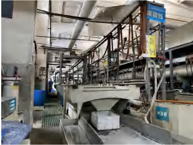
2#厂房-滚镀镍生产线（地上槽体/生产线）
