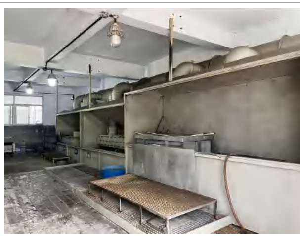
危废库旁-酸洗退镀线（地上槽体/生产线）
