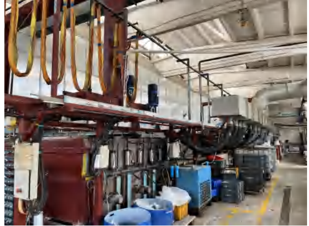
2#厂房-挂镀锌生产线（地上槽体/生产线）
