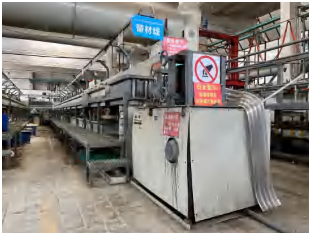
2#厂房-钢带镀镍生产线（地上槽体/生产线）
