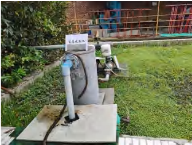
污水站-应急收集池（地下）
