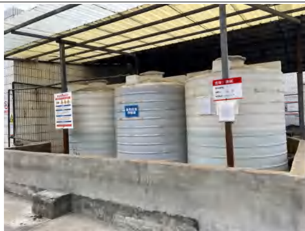
污水站-药剂配置储罐围堰+顶棚
