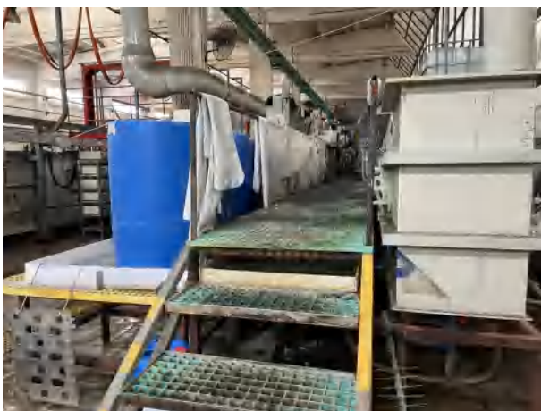
2#厂房-挂镀镍生产线（地上槽体/生产线）
