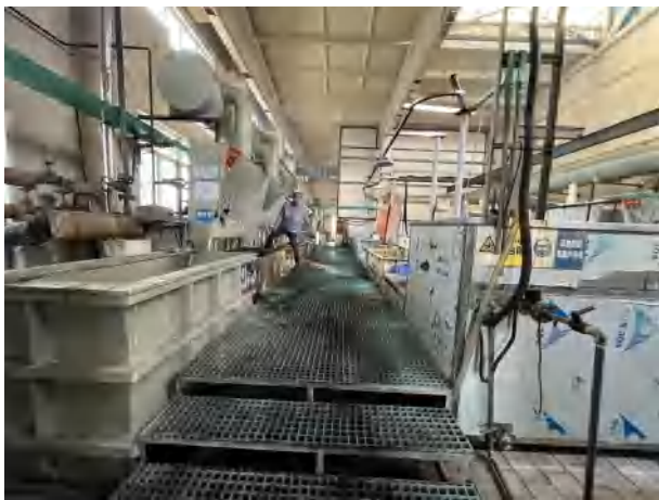
2#厂房-阳极氧化前处理（地上槽体/生产线）
