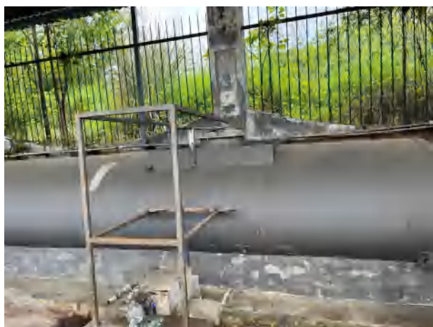
离地酸罐+围堰
