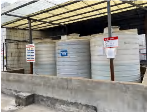
污水站-药剂配置储罐围堰+顶棚
