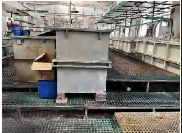
2#厂房-阳极氧化后处理（地上槽体/生产线）
