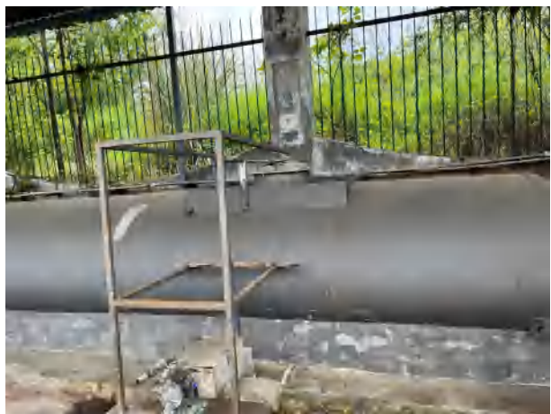
离地酸罐+围堰
