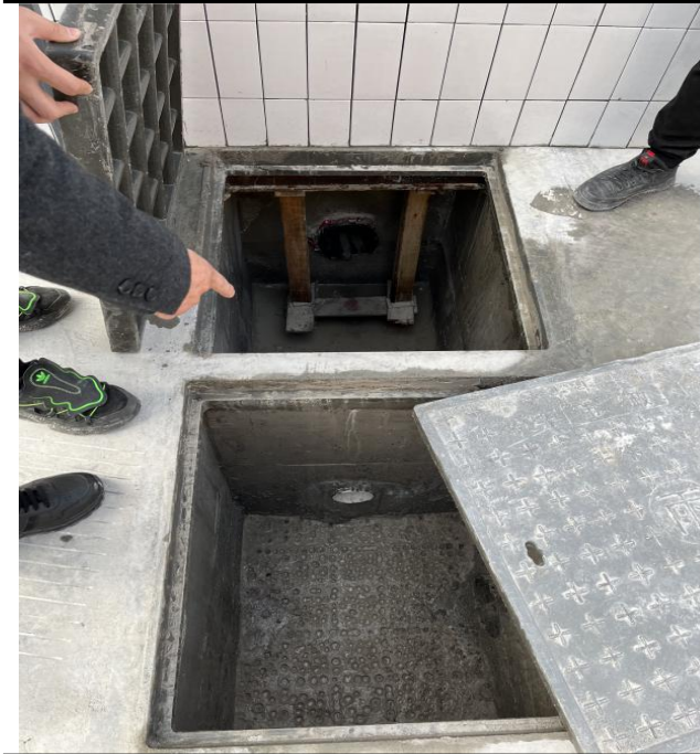
洗车废水隔油池+沉淀池
